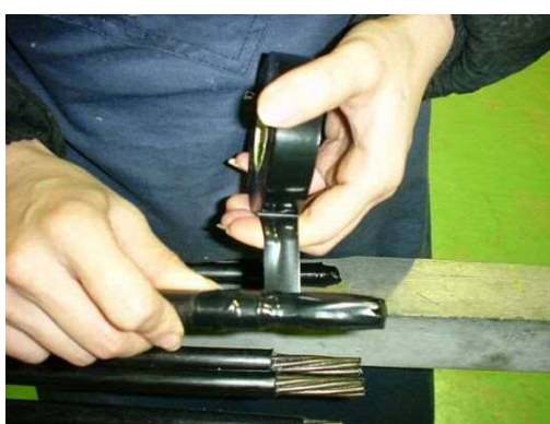
図 5.6.3 アンボンド PC 鋼より線ジャッキ側端部のビニールテープによる処理
