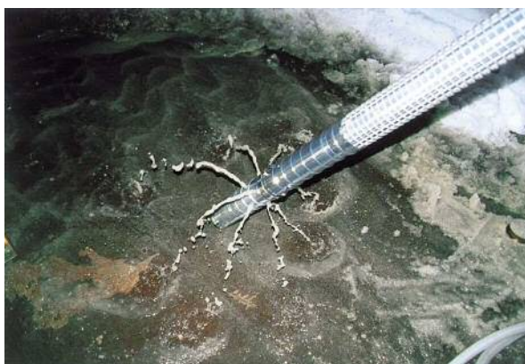
図 1.2.6 耐荷体からのグラウト排出状況
